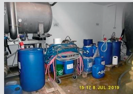
↑ Abbildung 8: unsachgemäße Lagerung von Gefahrstoffen
